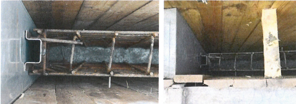
Kuva 6-1 ja 6-2. Suojaetäisyys oli liian pieni vasemmassa reunassa olevaa päätymuottia vasten. Oikealla työmaakokouksen jälkeen urakoitsijalta saatu kuva korjatusta raudoituksesta.
